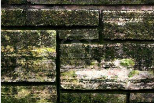
Şekil 7. Mantarların taş duvar yüzeyinde sebep olduğu renk değiştirmeleri ve kararmalar şeklinde görülen mantar alterasyonları (17)
